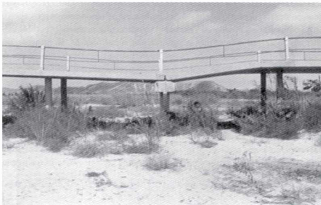
Fotografia 1.2 - Situação de recalque de fundação
