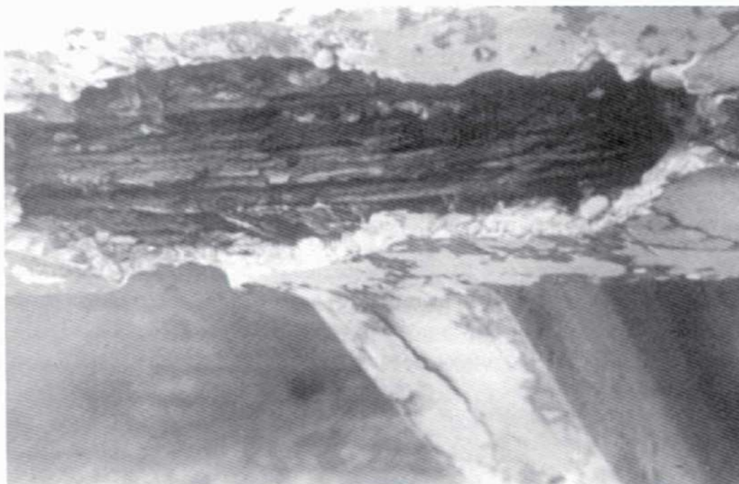
Fotografia 1.6 - Deslocamento do concreto causado pela corrosão das armaduras
