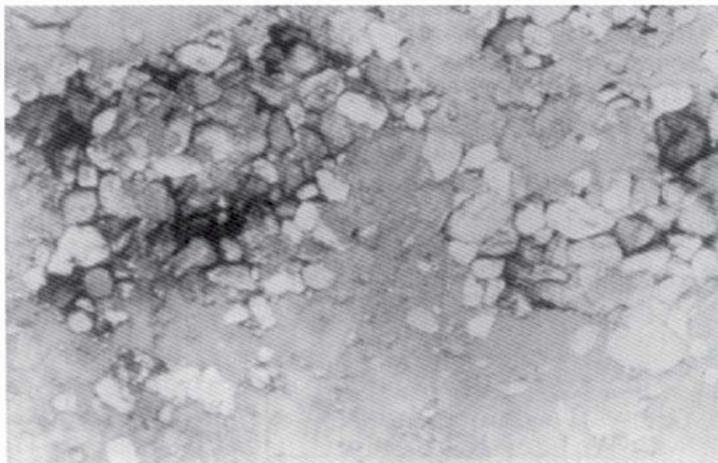
Fotografia 1.9 - Desgaste do concreto por abrasão
